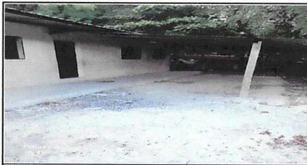
Foto 5: Torta de plancha de concreto. ✓
