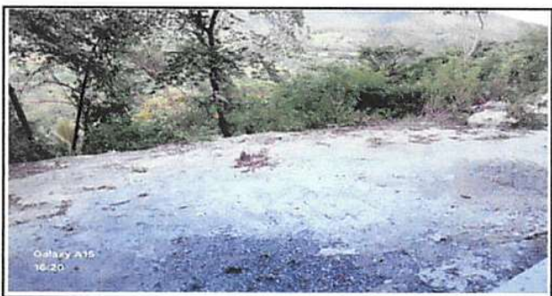
Foto 6: Torta de plancha de concreto. ✓
